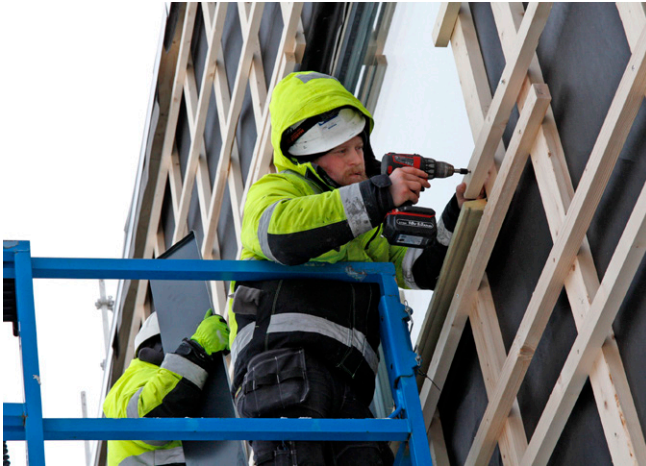
Mange prosjekter innenfor bygg og anlegg gjør at etterspørselen etter fagfolk er stor. Her jobber håndverkere fra Skanska med å bygge nye Steinkjer skole. Foto: NAV Trøndelag
